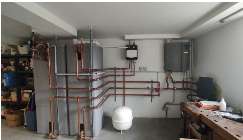
Wärmepumpe im Kellerraum (Bildquelle BWP)
