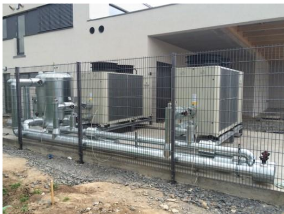
Zwei Wärmepumpen tragen zur optimalen Energienutzung bei. (Bildquelle: Überlandzentrale Lülsfeld eG)
