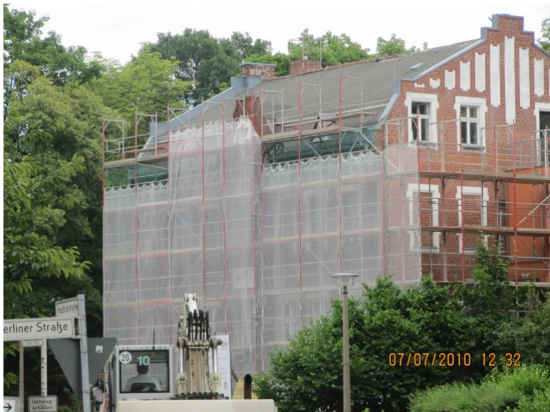
02_Montessori Schule: Obwohl die Fassade des denkmalgeschützten Gebäudes fast unverändert erhalten blieb, konnte der Primärenergiebedarf von 365,7 kW auf 117,8 kW pro Quadratmeter und Jahr gesenkt werden. Den kompletten Wärmebedarf deckt nun eine Sole/Wasser-Wärmepumpe. (Quelle: Integra Planen und Gestalten)
